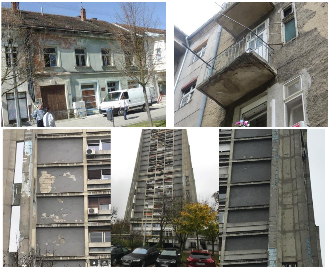
Slika 28 Primjeri oštećenja na zgradama uslijed dotrajalosti i neodržavanja
