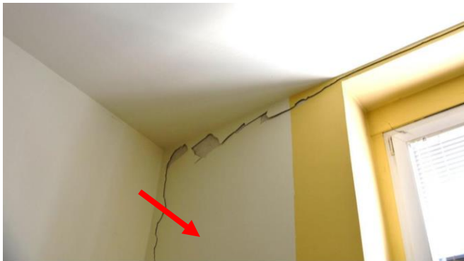
a) Pukotine na spojevima zidova i zidova sa stropom
