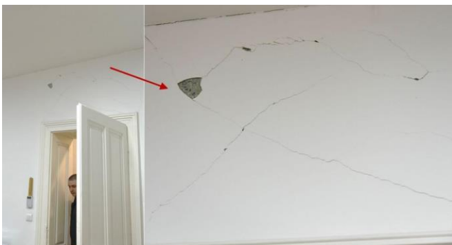
c) Pukotine u nosivim i pregradnim zidovima
