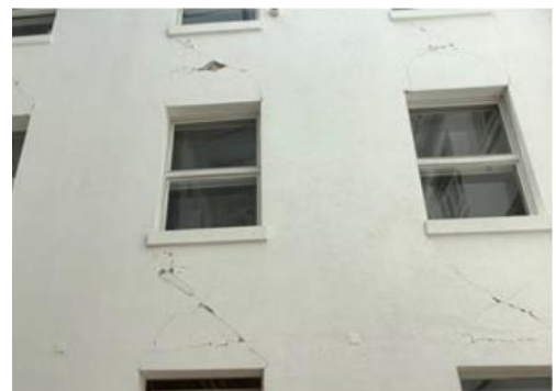
d) Pukotine na zidovima pročelja
