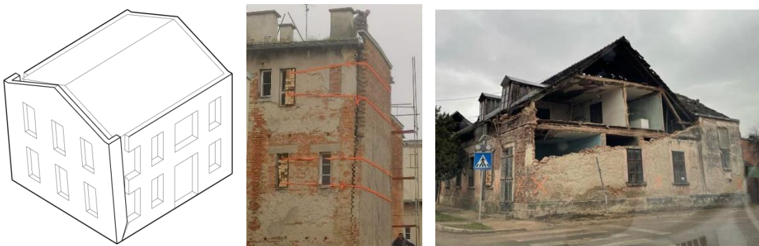
Slika 2 Gubitak cjelovitosti konstrukcije i odvajanje zidova od stropova zbog nedovoljne povezanosti
