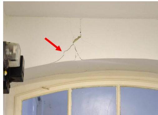
b) Pukotine u nadvojima
