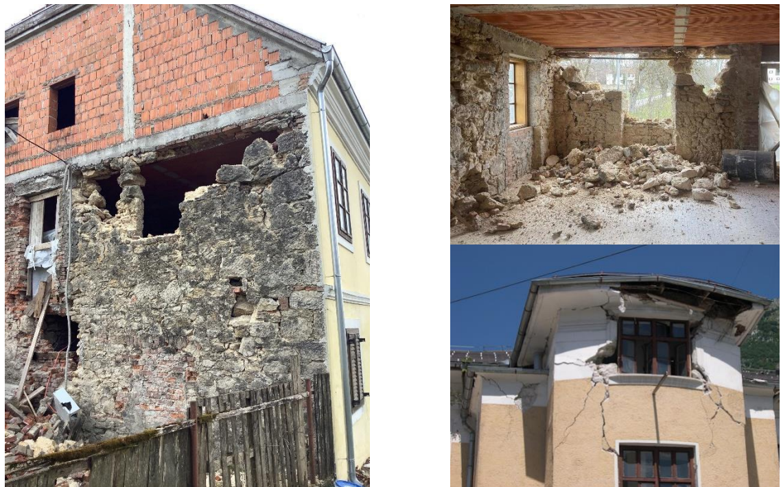
Slika 6 Fotografije degradacije zida zidanog od lomljenog kamena u potresu
